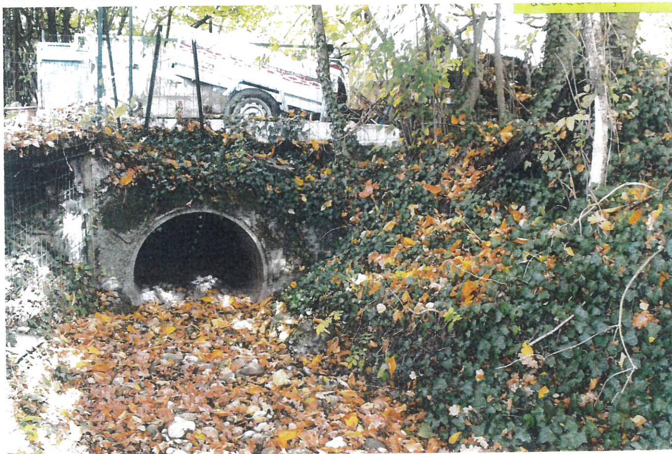
BUSAGE NON ALIMENTÉ, APRÈS DÉVIATION
