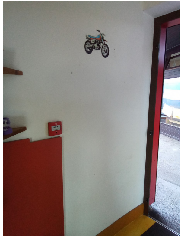
Boîtier hall à côté de la sortie de secours
