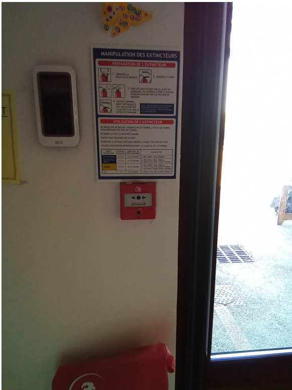
Boîtier déclencheur dans le hall de l'école
