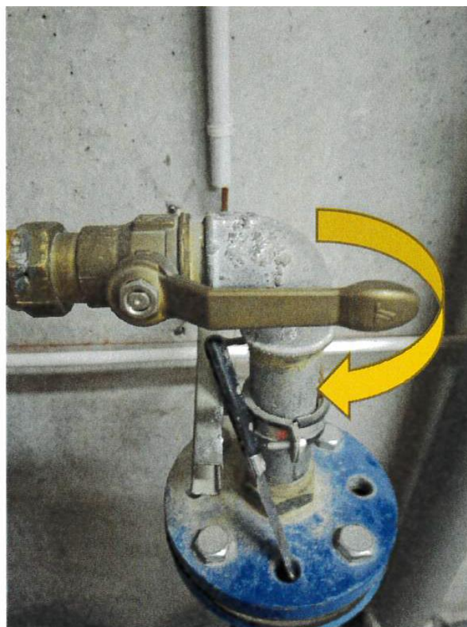
Vanne de coupure générale de l'eau
